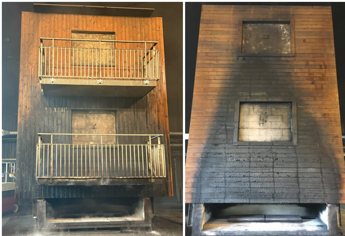
Figur 8. Skadebild på fasaden efter prov för det aktuella försöket till vänster och för försök utan balkongplattor till höger. Observera att den vänstra uppställningen är bredare än den högra.
