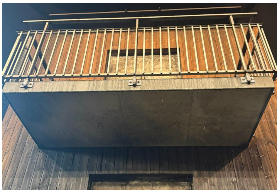
Figur 14. Bild på övre balkongplatta efter avslutat prov. Plattan är endast missfärgad och inte skadad.
