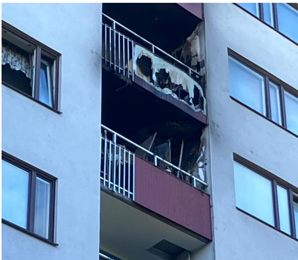
Figur 6. Trolig spridning från våning 7 till våning 8 på grund av utslående lågor som låg dikt ann mot balkongräcke ovan brand.
