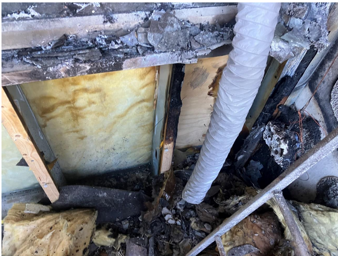
Figur 3. Bild på fasad under balkongfönster sett utifrån. Förkolnad trä under balkongfönster, där mest förkolning skett till höger i bild.
