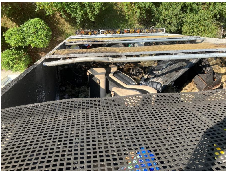
Bild 3. Den öppna konstruktionen vid balkongräckena och aluminiumgallren där branden spred sig.
