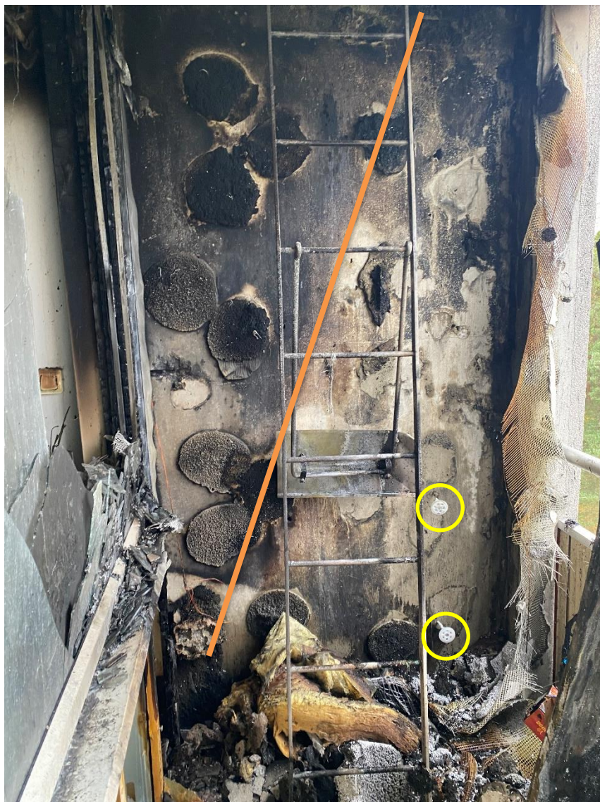
Figur 4. Bild på startbalkong sett från balkongdörr där kolningsbilden indikerar att branden varit till vänster i bild, se orange linje. Plaststag, inringat med gult, indikerar även att brandens placering var i hörnet då de till höger långt ner är opåverkade och de till vänster brunnit bort.
