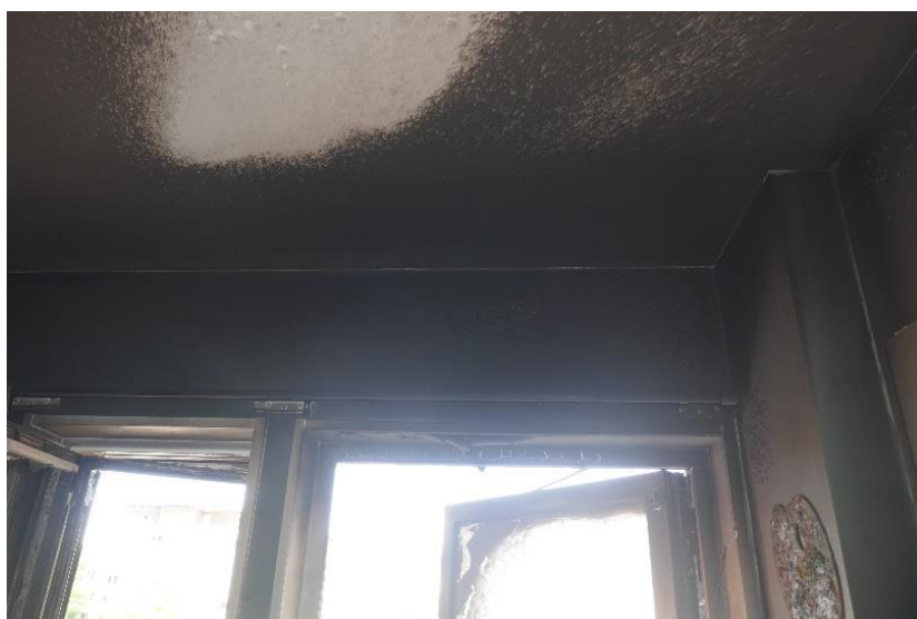
Figur 8. Sotskador i tak.
