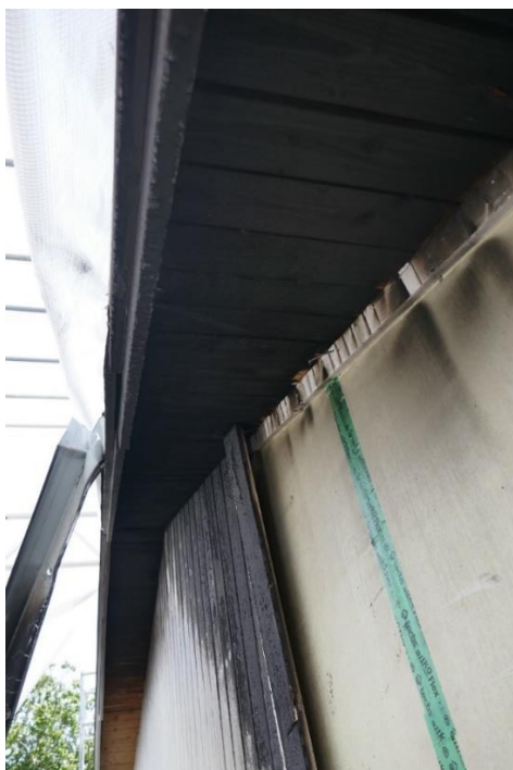
Figur 15. Yttreväggen ansluter mot råspoten rakt ovanför balkongerna.
