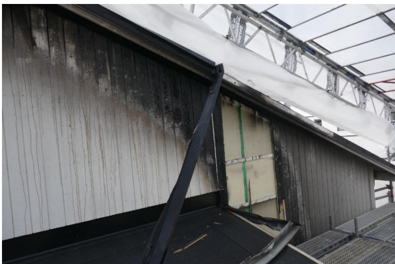
Figur 12. Brandskador längs med takfoten.
