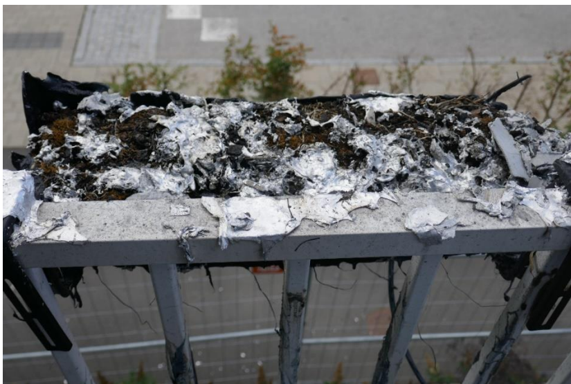
Figur 4. Smält aluminium som droppat ned från de ovanliggande balkongerna. Fotot är tagit på balkongen på plan 2.
