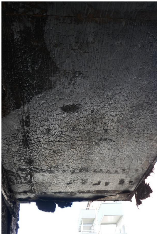
Figur 17. Brandskadat trä på undersidan balkongplatta. Foto taget på plan 2.
