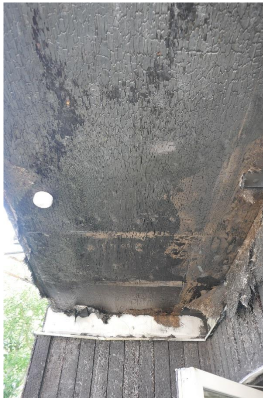
Figur 18. Brandskadat trä på undersidan balkongplatta. Fotot taget på plan 2. Brandvarnaren är monterad efter branden.
