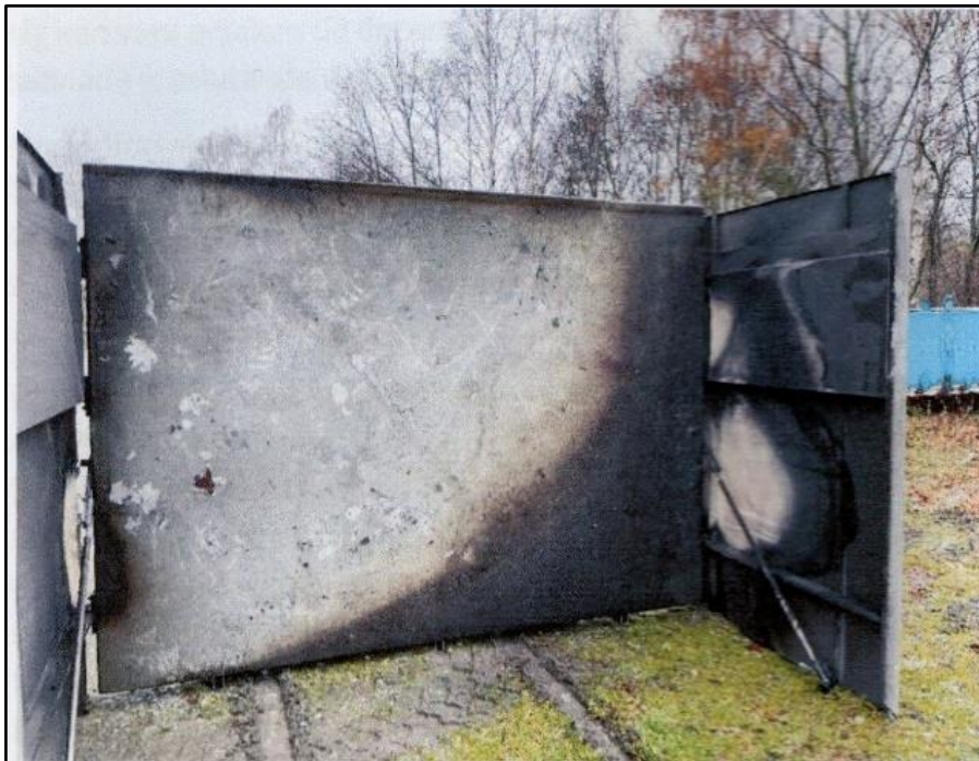
Figur 25. Ovansidan balkongplatta efter försöket.
