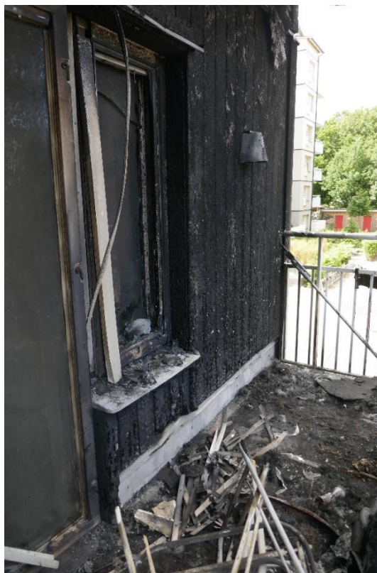
Figur 6. Fönstret bredvid balkongdörren hade sotavlagringar på innersta glasrutan. Yttre rutan hade gått sönder.
