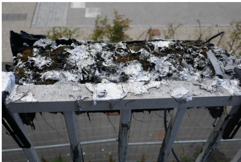
Figur 4. Smält aluminium som droppat ned från de ovanliggande balkongerna. Fotot är tagit på balkongen på plan 2.
