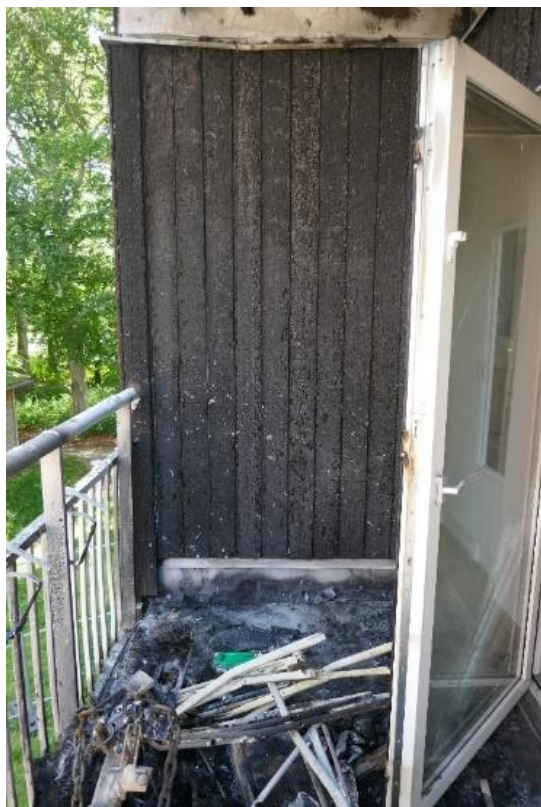
Figur 5. Fasaden är kraftigt brandskadad. Balkongdörren har inga brandskador i dörrkarmen.
