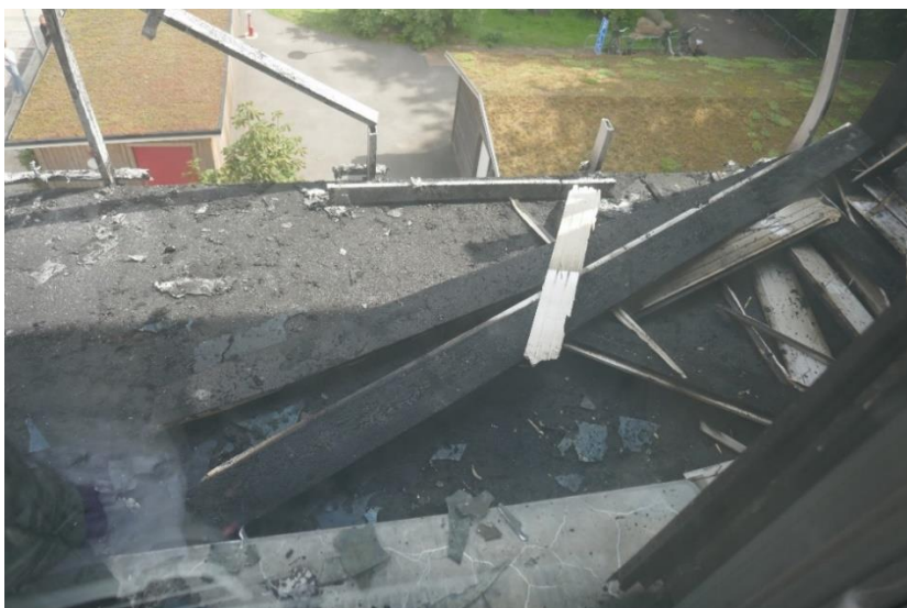
Figur 11. Brandskador på balkongen. Liten mängd brännbart material på balkongen, det som syns i fotot är fasadpanel som brutits bort.
