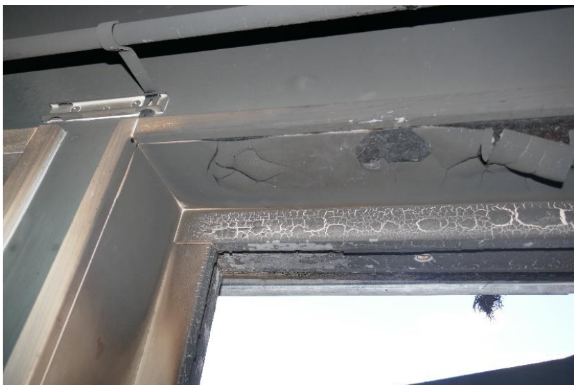
Figur 9. Brandskador invändigt på karmen till balkongdörren.
