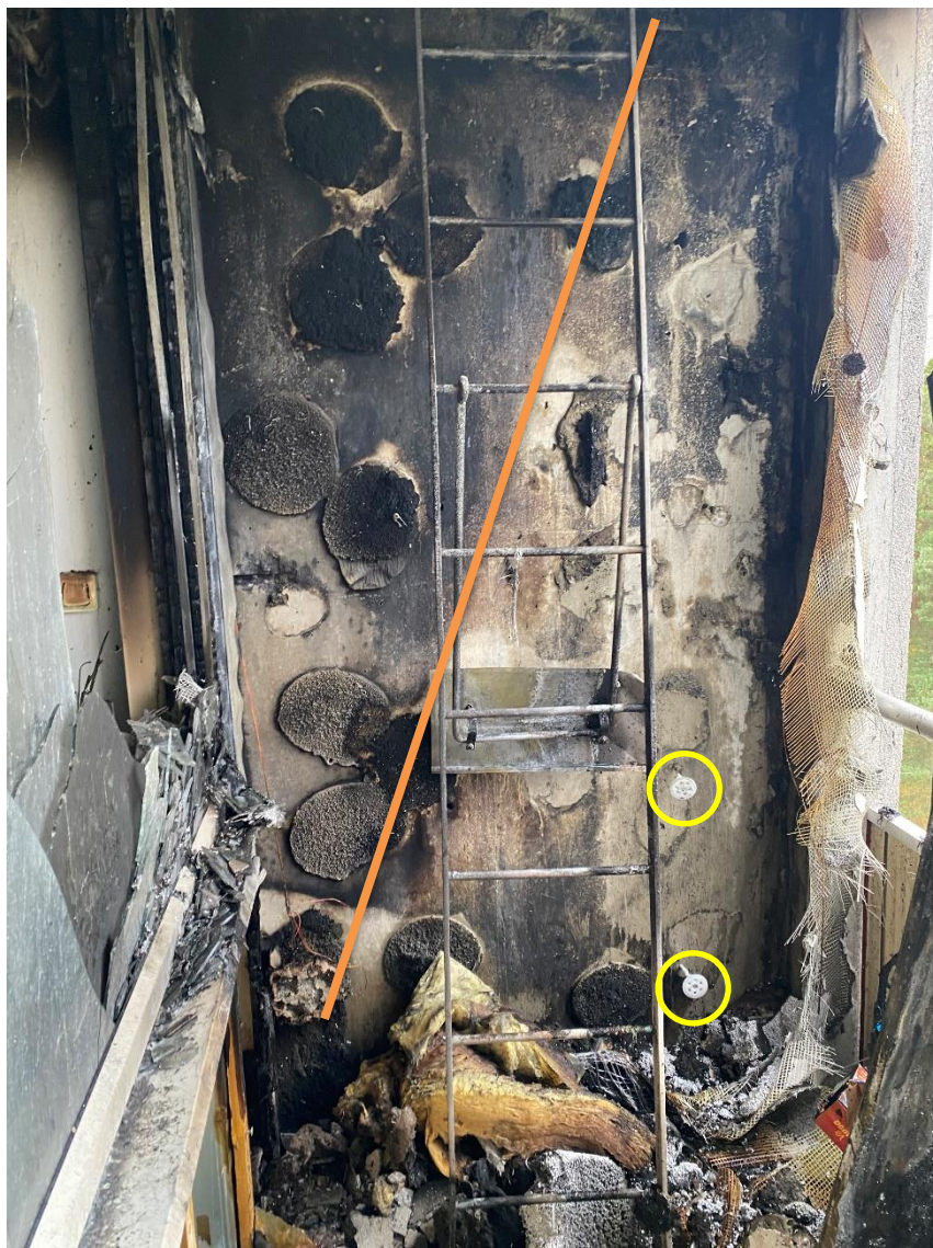
Figur 4. Bild på startbalkong sett från balkongdörr där kolningsbilden indikerar att branden varit till vänster i bild, se orange linje. Plaststag, inringat med gult, indikerar även att brandens placering var i hörnet då de till höger långt ner är opåverkade och de till vänster brunnit bort.
